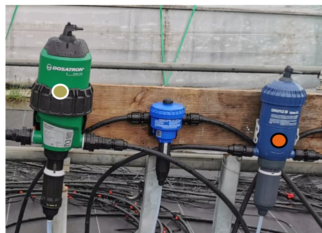
Installation des pompe doseuse volumétrique – essai FOLI © VALENTIN DUQUESNE, ASTREDHOR
