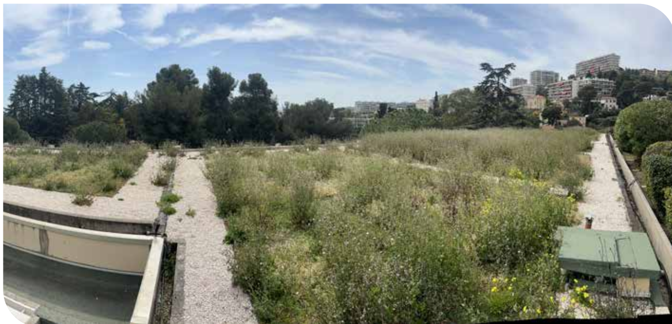
Photo de l'ensemble de cette toiture et des végétaux non-attendus par la copropriété (© non déterminé)
